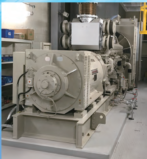
非常用ディーゼル発電装置 1600kVA
