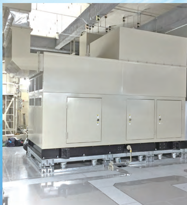
非常用ガスタービン発電装置 1500kVA
