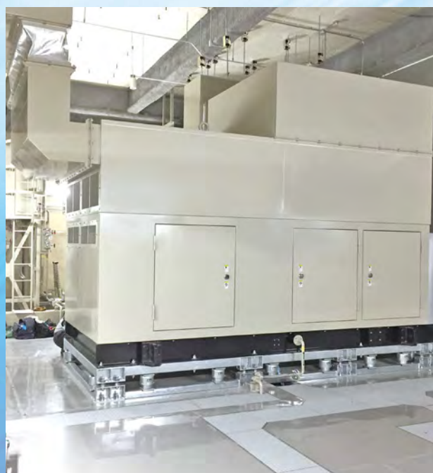
非常用ガスタービン発電装置 1500kVA
