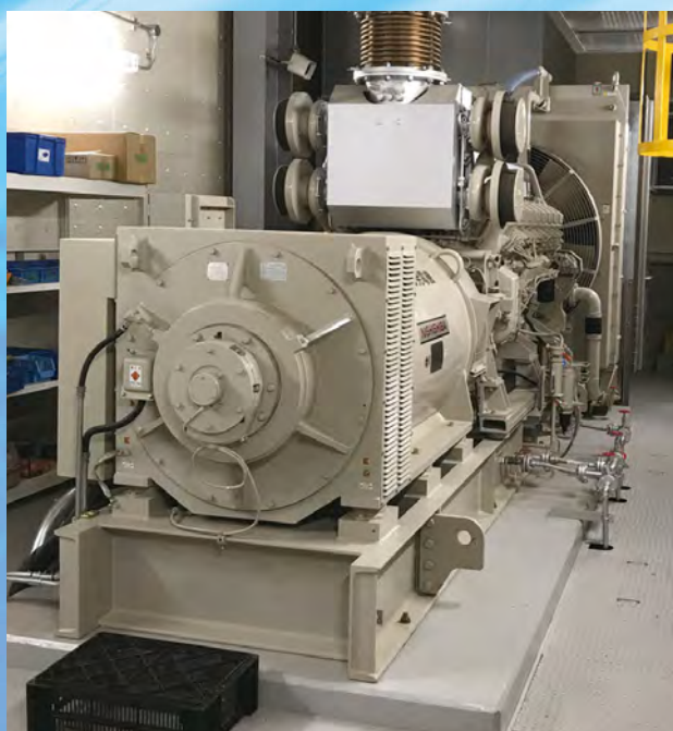
非常用ディーゼル発電装置 1600kVA
